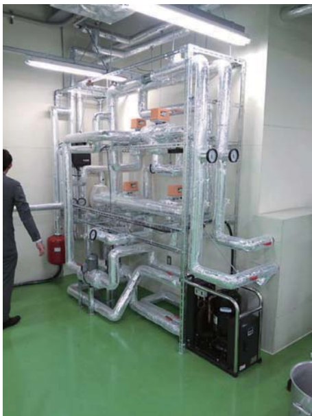
新設工場様 事務所床暖房/床冷房用 地中熱利用ヒートポンプ 10馬力×1台
