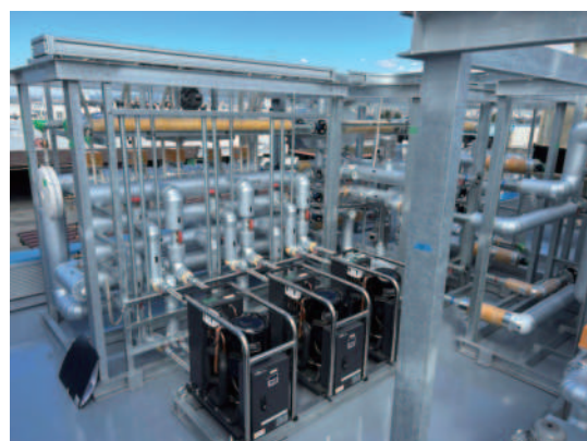
新築工場の排水熱利用空調省エネ: 新設工場の井水、排水熱を利用した冷暖房システム。普段はそのまま捨ててしまう加工後の汚れた排水から熱エネルギーを採熱し床暖房や床冷房をはじめとした各設備に活用
