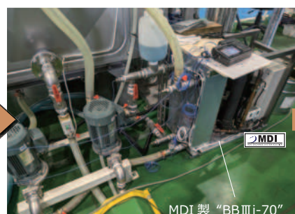
ヒートポンプ設置: 小型軽量なため現場設置が容易となり、社内メンバーだけでも設置が可能。蒸気レス化が実現。
