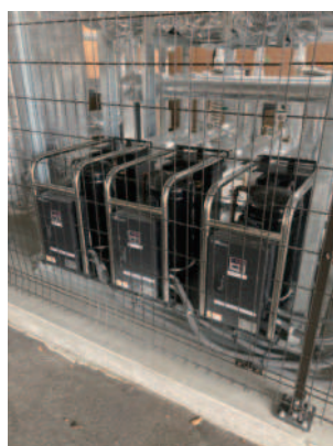
高級温泉旅館の排水熱回収: 汚れ + 腐食がある温泉排水を回収し温湯を作り出すため、ボイラー稼働を大幅削減した熱回収システム
