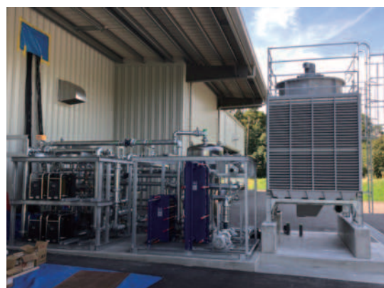
発泡ウレタン断熱パネル工場でのフリークーリング設備: CO2 削減を必須とする現場向け。18℃~20℃冷水システム。現場に MDI 製フリークーリングシステム + チラーを 4 台導入。省エネ効果は高効率空冷チラーと比較し -50~-70% の大幅な消費電力削減。年間 2/3 はチラーが稼働しないで冷水を製造
